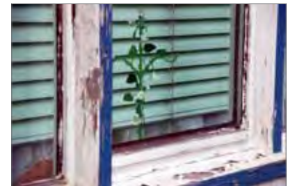
Abb. 14: Fenster im ursprünglichen Zustand, Modernisierung notwendig (Teichmann)
