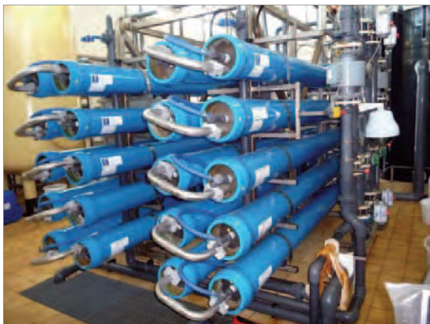
Abb. 124: Membranfilter der Meerwasseraufbereitungsanlage (Versorgungsbetriebe Helgoland)
