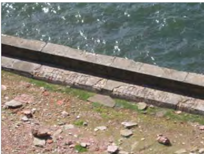
Abb. 106: Beschädigungen an der Mauerkrone (eigene Aufnahme: 2009)
