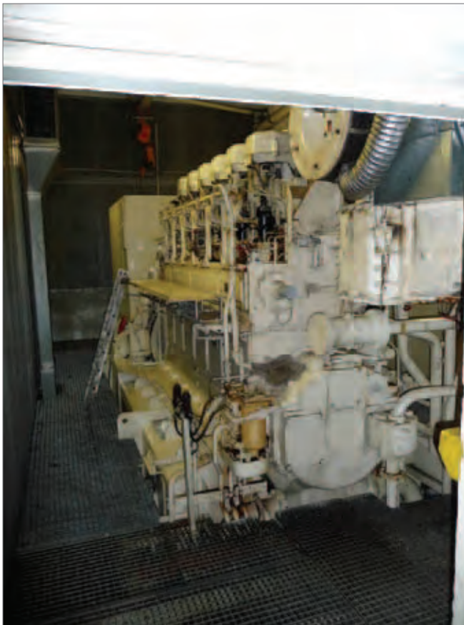
Abb. 122: Ein Dieselaggregat des Heizkraftwerkes Helgoland (Versorgungsbetriebe Helgoland)
