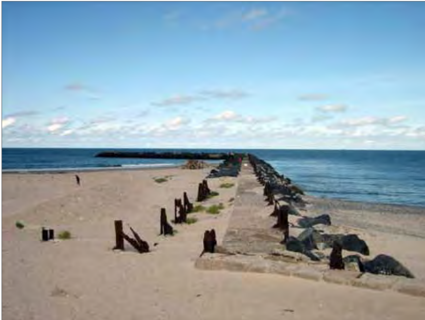
Abb. 115: Dünendamm Ost mit Granitblock-Vorschüttung. Im Vordergrund die alten Strukturen des Molenbauwerkes (eigene Aufnahme: 2009)
