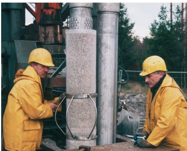
Abb. 16: Einbau eines Filterrohres (links, rechts ist ein Vollrohr zu sehen). Erkennbar ist auch das Kiesmaterial, welches das Filterrohr umgibt (Fa. Gebr. Lange, Halstenbek)
