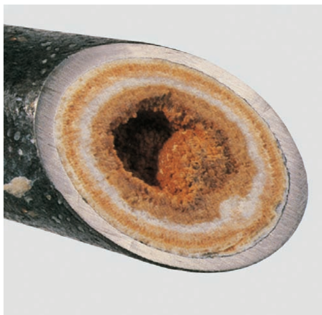
Abb. 14: Verockerung in einem Wasserleitungsrohr (Wasserfibel, Maitron GmbH)
