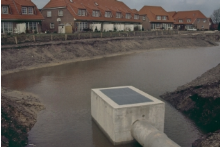
Die eingriffsintensive und häufig kostenträchtige Anlage eines Regenrückhaltebeckens in dieser Form entspricht heute nicht mehr dem Stand der Technik.
