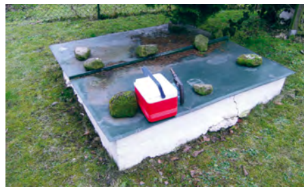
Undichte, mangelhafte Abdeckung
