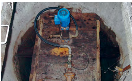
Stark verschmutzte, offene Holzabdeckung
