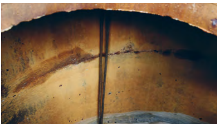
Feuchtigkeitseintritt zwischen Schachtringen
