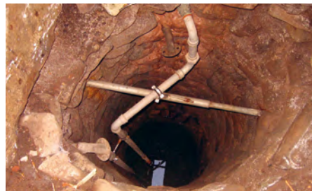
Korrodierte Rohre, starke Eisenoxidausfällungen
