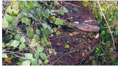
Korrodierte, nicht tagwasserdichte Abdeckung
