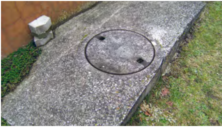
Risse in der Betoneinfassung führen zu Undichtigkeiten
